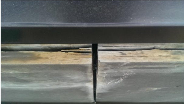
Abb. 4: Der Zahn der Zeit nagte früh an den Schieferplatten. Witterungseinflüsse und Organische Ablagerungen in den Schichten ließen das Material aufplatzen.
